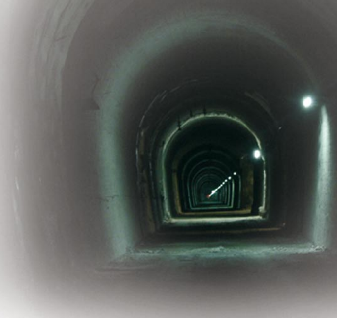
Interior del Túnel del Somport, Canfranc (Huesca), en el que se encuentra el Laboratorio Subterráneo de Canfranc.
